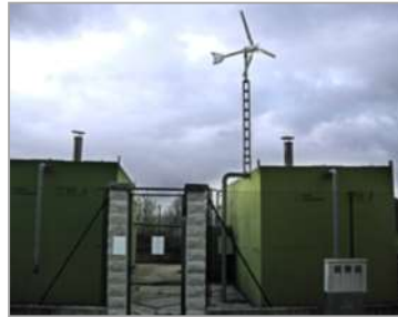
Figura 33: Instalación eólica en EDAR Baltar . Fuente: Proyecto RETALER II
