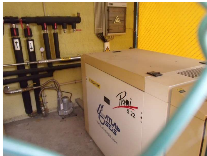
Figura 26: Uno de los módulos de cogeneración
