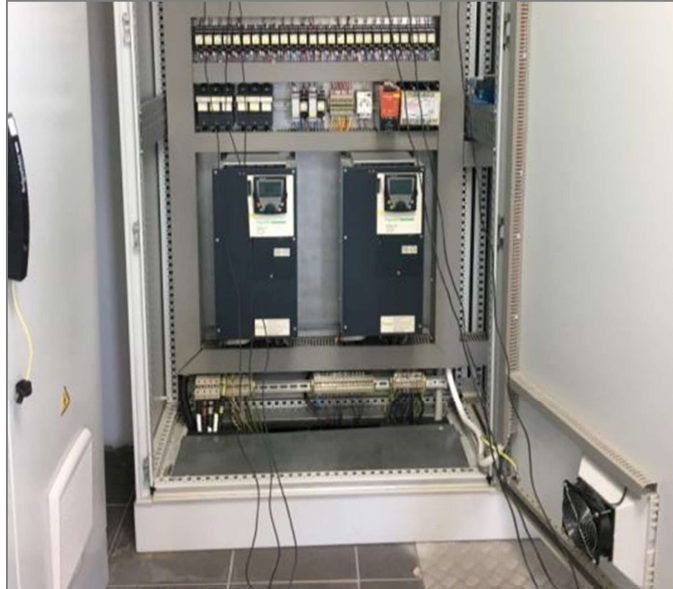
Figura 2; Variadores de frecuencia para la regulación de caudal de bombas de recirculación en EDAR de Ribadumia.
