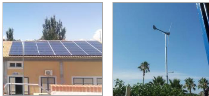
Figura 32: Instalaciones renovables EDAR Archena. Fuente: Proyecto RENEWAT
